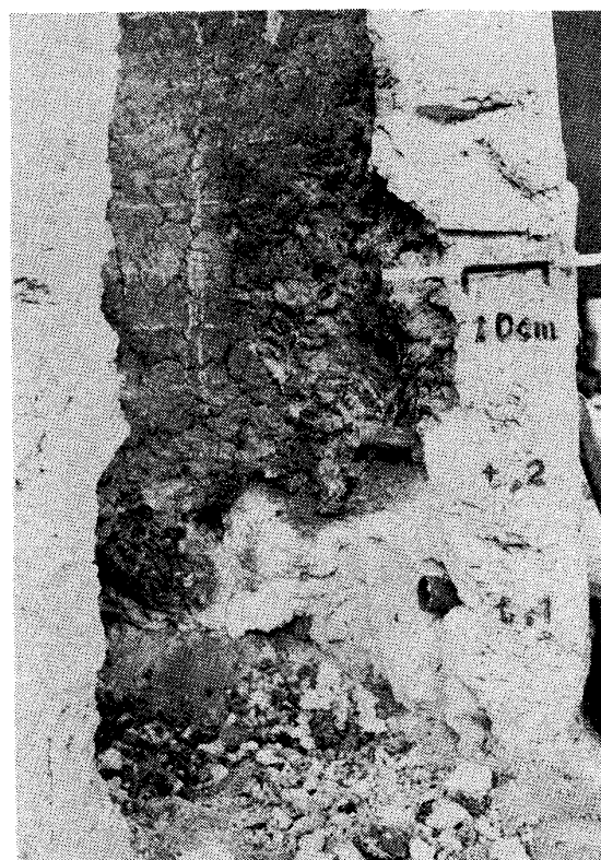
写真 1 通風孔側炉壁下部溶損状態
